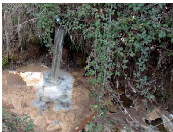
Rejet de la station d'épuration de Pourrières
