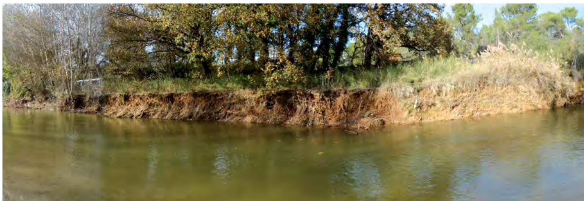
Érosion sur l'Arc à Aix-en-Provence, 2012
